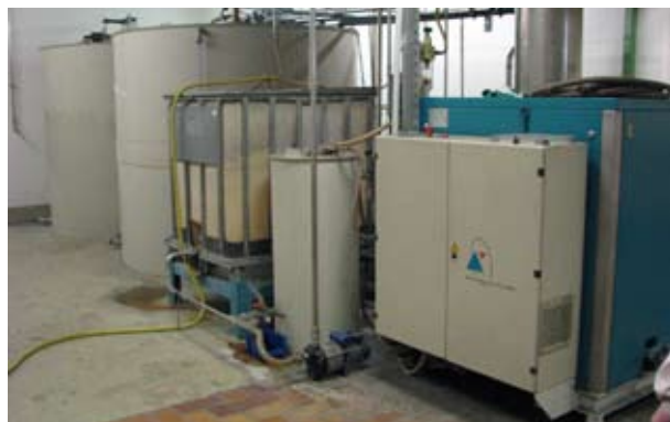
Prozesswasseraufbereitung durch Ultrafiltration
