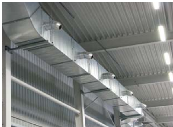
Abwärmennutzung aus der Lackieranlage
